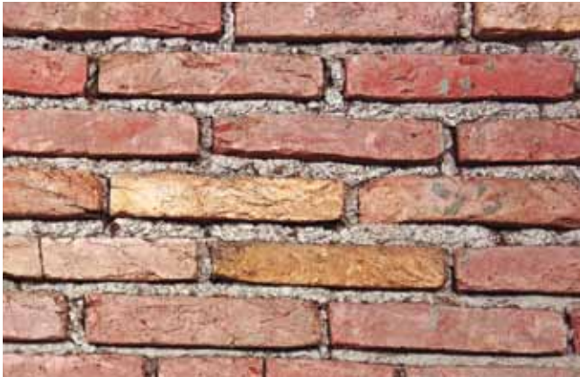
Niet vlak, gereinigd metselwerk
