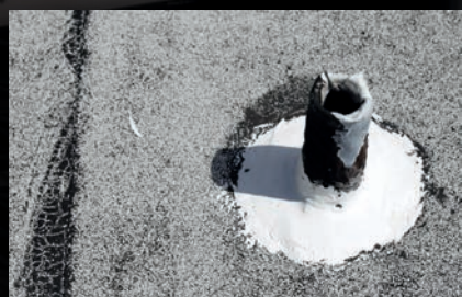
Een lekkend dak?
